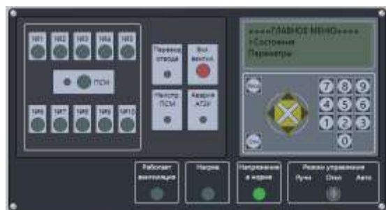
Станция управления АГЗУ на SCADA консоли
