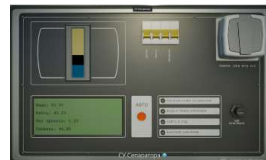
Станция управления сепаратора
