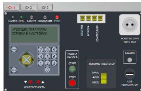
Станция управления насосом КНС на SCADA консоли
