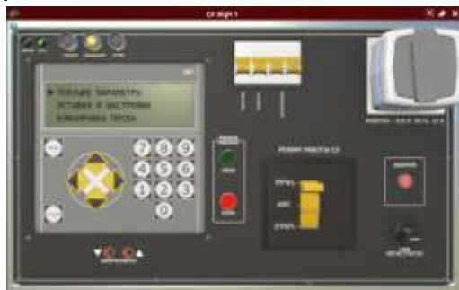
Станция управления ЭЦН
