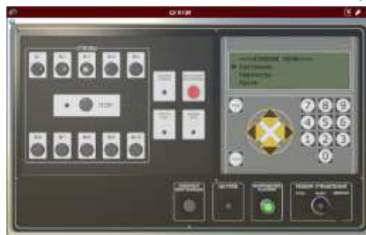
Станция управления АГЗУ
